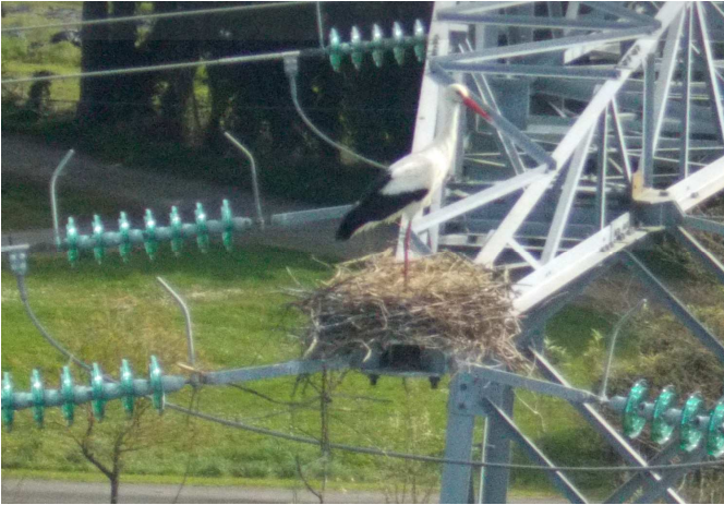
Le nid avant l'intervention (photo RTE)
